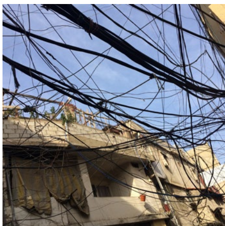
Bourj el Barajneh, cavi elettrici (foto by Michele Piras)
