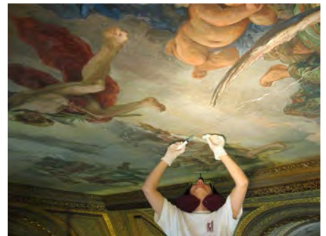
Galleria dei Candelabri, Cantiere di restauro, part. Foto © Musei Vaticani, Governatorato SCV
